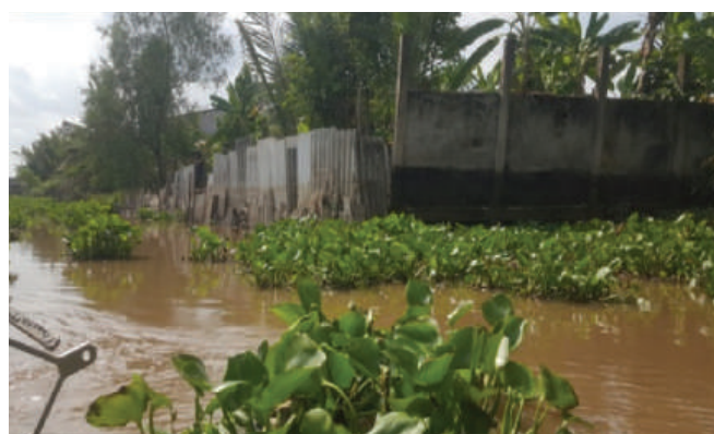
Hình 6. Hiện trạng sạt lở bờ sông Nhu Gia
